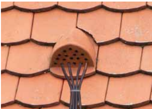
Chybné řešení prostupu elektroinstalace
