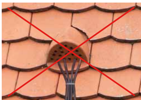
Chybné riešenie prestupu elektroinštalácie
